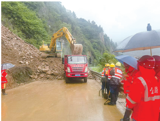
茶陵相关部门正在抢修因山体崩塌而中断的道路。王宏鹏 供图
