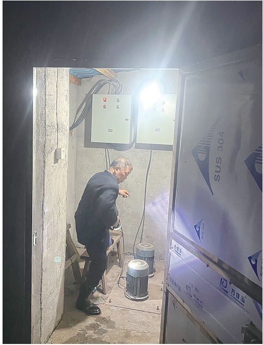
雨夜里,张必秋打开排涝机台室的电闸为抽水机送电。受访者供图
