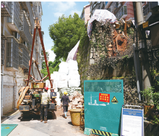
片石护坡垮塌现场。记者/盛荣 摄
