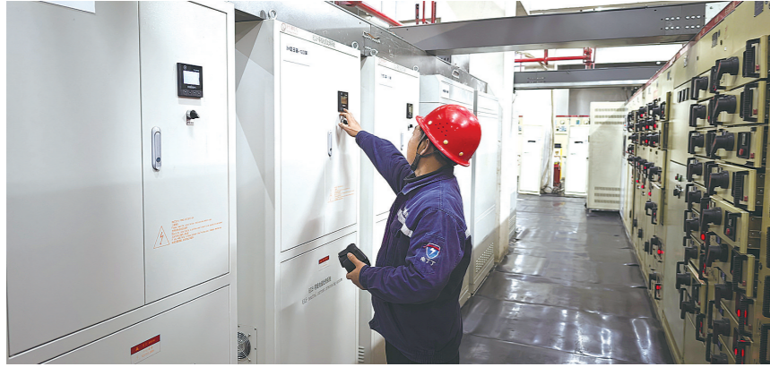
整改工程共安装了20台零线电流处理设备。记者杨凌凌摄
