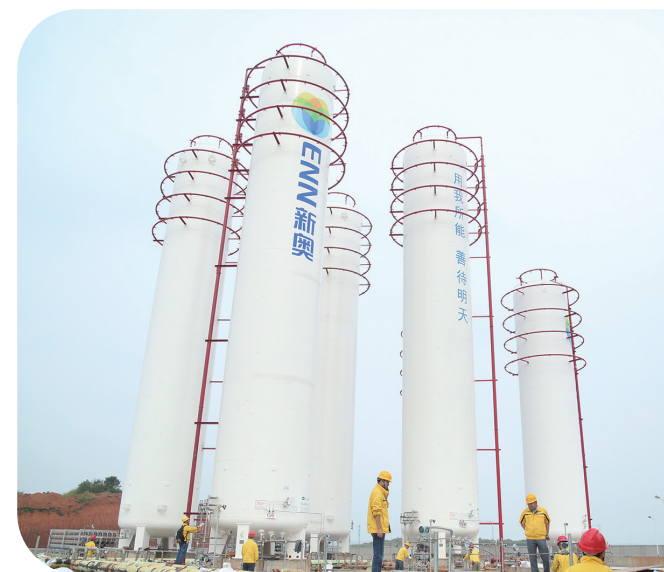
绿口区南洲新区LNG储配站
