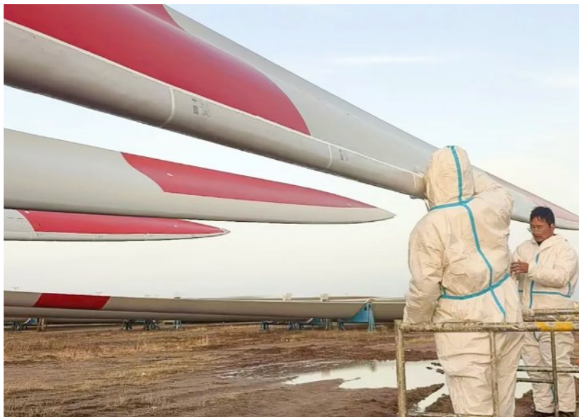
时代新材售后人员正在进行前缘保护膜施工。通讯员供图
