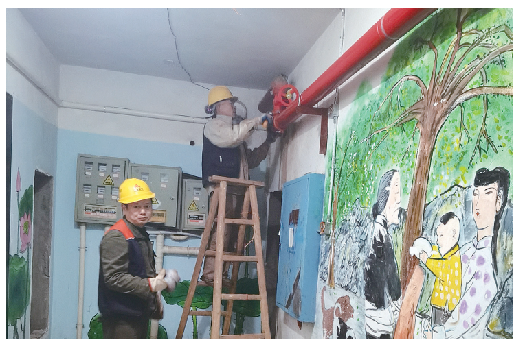
经过“花园议事会”协商后,嘉天紫苑苑小区消防设施整改。受访者供图
