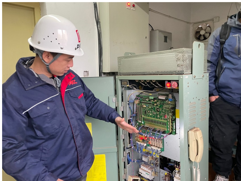
购买电梯维修保险的小区在开展电梯体检。记者/张威 摄(资料图)
