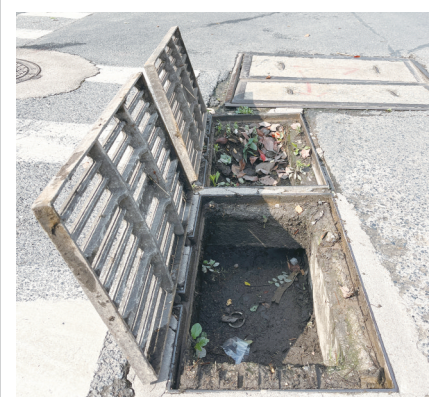
响田西路一处雨水口被泥土堵塞。 记者刘平 摄
