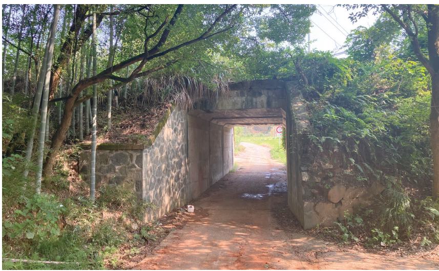
低矮的铁路涵洞,形成交通堵点。记者/姚时美 摄
