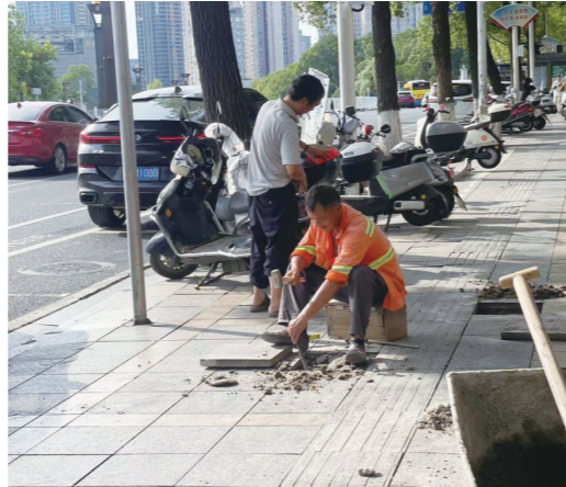
天元区市政队员在珠江南路上修缮人行道地砖。 记者/伍靖雯 摄
