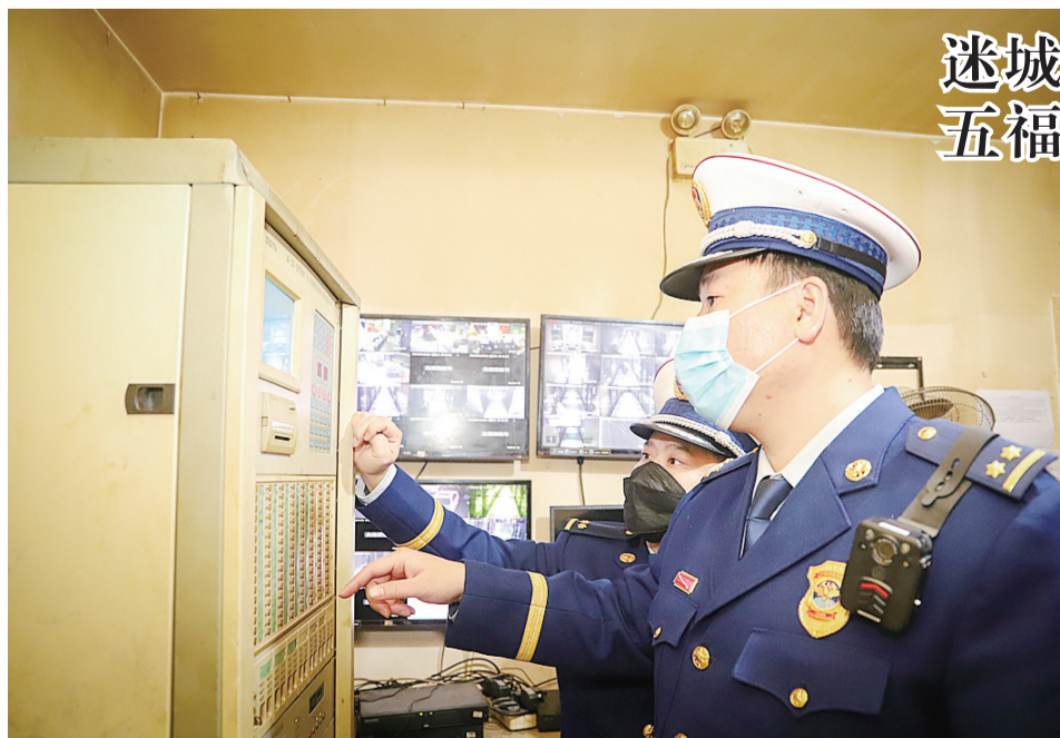
消防监督员随机检查娱乐场所消防控制室运行情况。通讯员 供图
