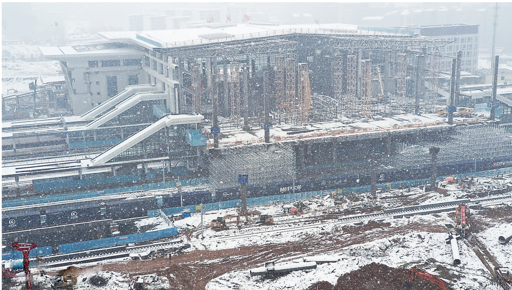
▲大雪纷飞,株洲火车站的工地上,工人们坚持奋战保进度。通讯员/金江 摄
