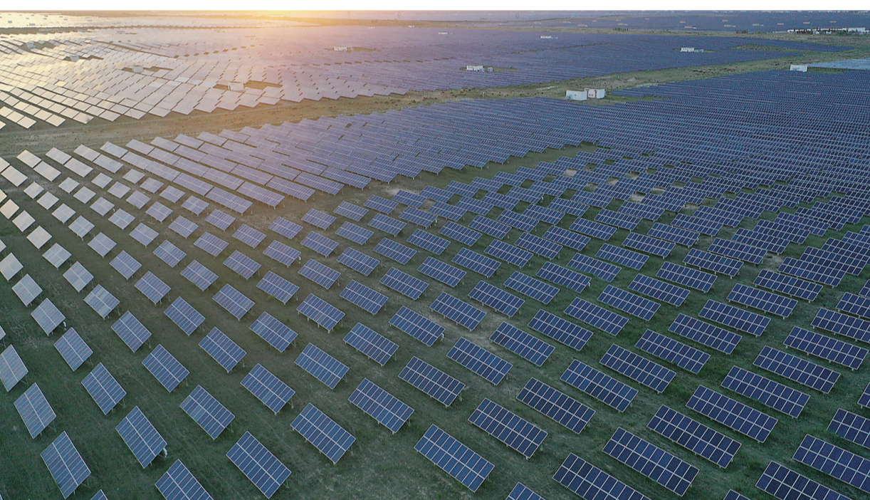
青海省海南藏族自治州共和县境内的大唐青海公司新能源分公司光伏电站一角(2020年7月7日摄,无人机照片)。新华社发
