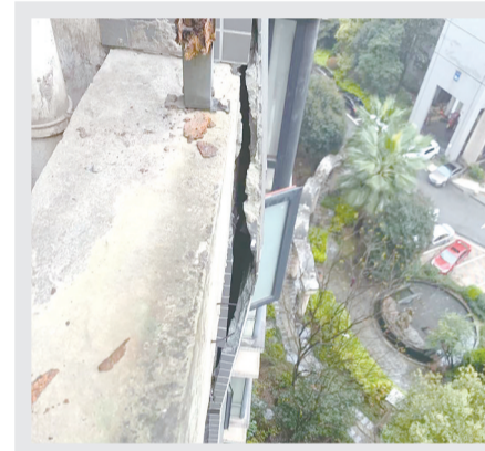
城市风景小区楼栋外墙脱落无人管理。记者/易楚瞳 摄
