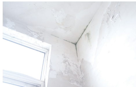
刘女士所住宿舍,顶楼天花板已经斑驳。黄欣雨 摄
