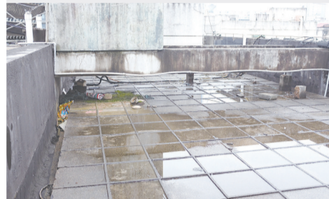
刘女士所住居民楼楼顶,一下雨就容易积水。黄欣雨 摄
