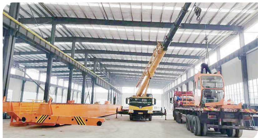
石峰区轨道交通装备产业扩能与制造智能化建设项目(道岔二期)现场。企业供图
