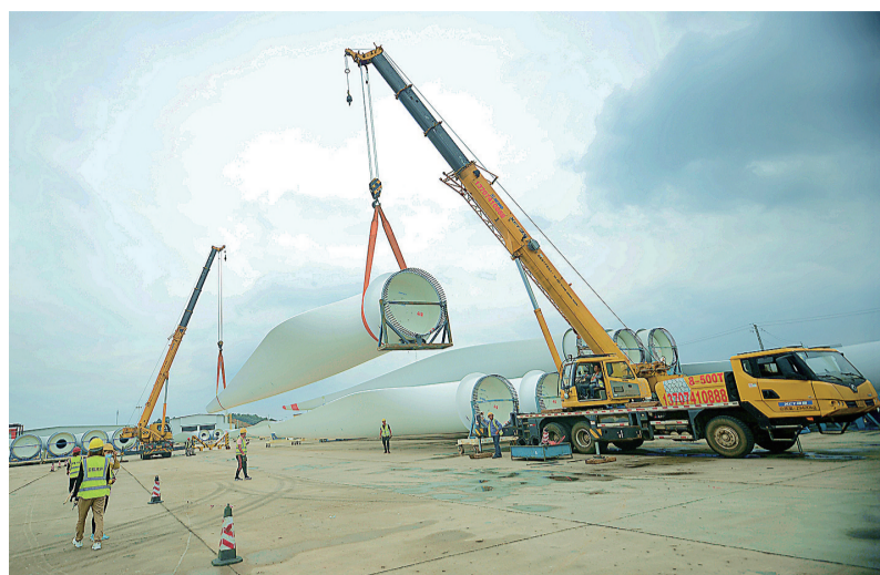
场外吊运班的工人在吊装风电叶片。他们需同时动用2台吊车,才能把这个庞然大物安放到特制的车架上。
