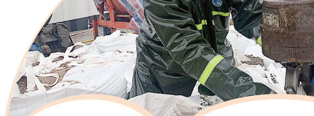
火车站改扩建项目现场工人正在吊装砂石。株洲日报·掌上株洲记者/吴楚 摄
