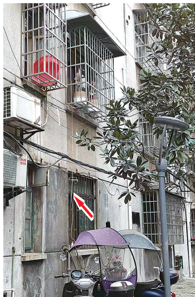
▲花园二村小区,电动车正在“飞线充电” 全媒体记者 马文章
