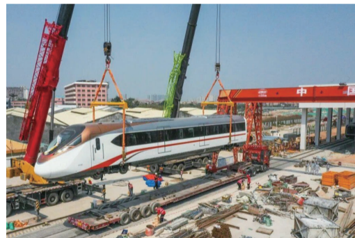
▲2月20日,广州地铁18/22号线电客车被吊装至脱枕停车场轨道上(无人机照片) 新华社记者 刘大伟 摄
