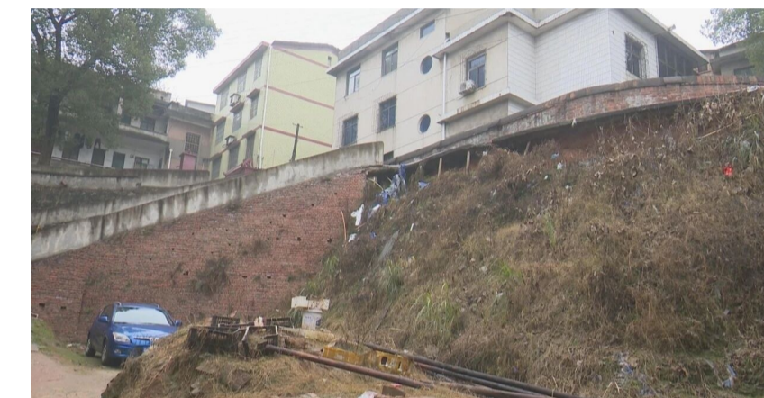
▲护坡垮塌现场,悬空的地方用木桩顶着 记者 陈驰 摄
