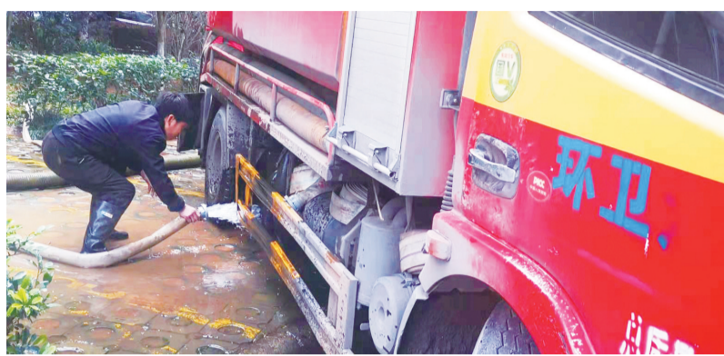
物业公司安排环卫车在小区内部疏通下水道。沈全华 罗伯钊 摄
