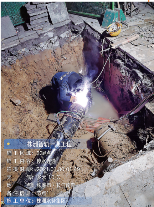
株洲智轨一期工程 施工区域：33#井 施工内容：停水埋管 拍摄时间：2021.01.30 01:39 天气：多云 10℃ 地点：湖南·株洲市·长江南路 备注信息：市电 施工单位：株洲水务集团
