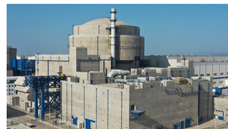
◀1月30日拍摄的“华龙一号”核电机组福建福清核电5号机组
