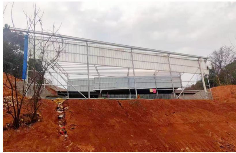
▲ 违规搭建的钢架棚 通讯员供图
