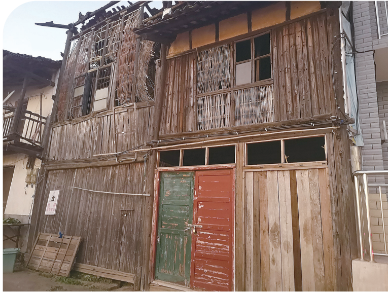
破旧的木质结构房子
