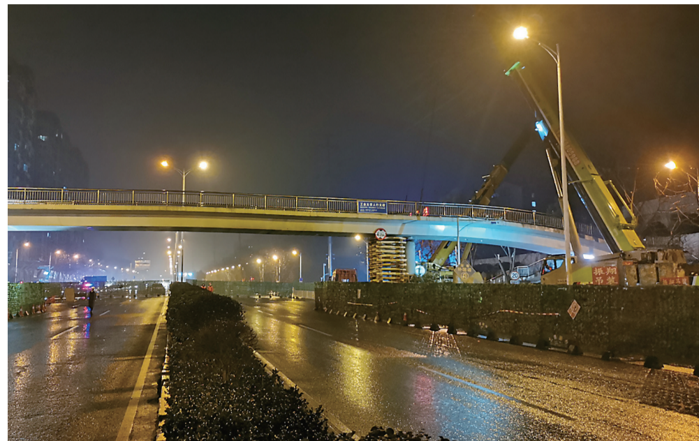
▲城管市政部门对东环线外国语学校附近人行天桥实施整体吊装复位 全媒体记者 任远 通讯员 朱熠 摄
