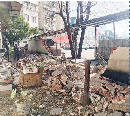
围墙倒塌,形成十米长的缺口。刘平 摄
