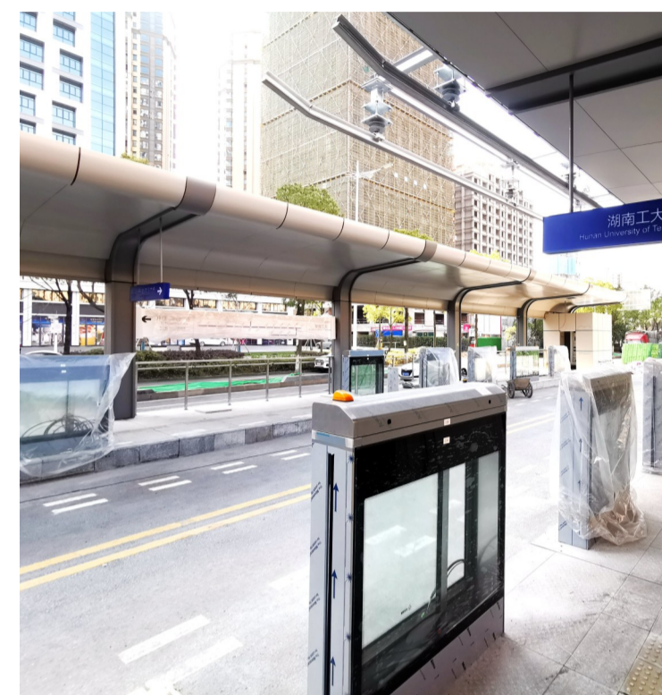
▲湖南工大站点标牌已经安装到位 记者 戴凛 摄
