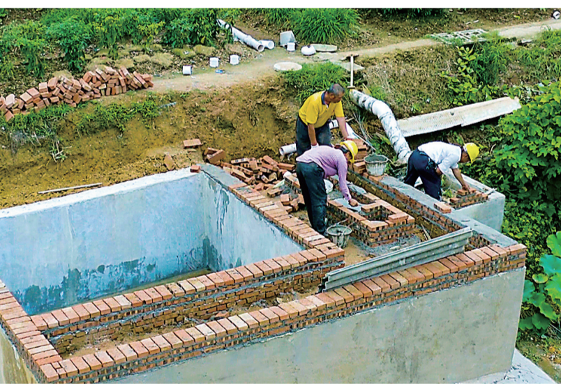
乡村污水处理工程。张睿龙 摄
