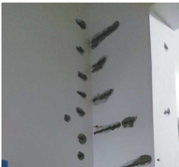
▲业主此前拍摄的钢筋外露情形 受访者供图
