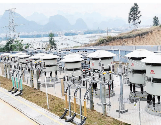
时代电气提供的SVC电能质量治理装置。 受访单位 供图
