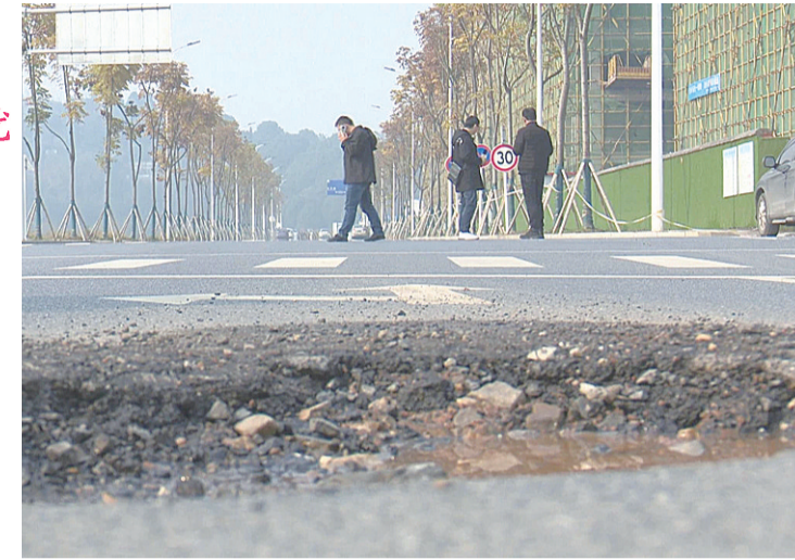
▲天枫路路面坑洼 记者 陈驰 摄
