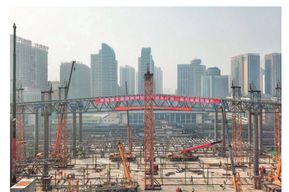
▲株洲站高架候车厅第一樁大跨钢桁架顺利就位 记者 李卉 摄
