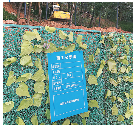
图为施工围挡上信息缺失的公示牌。
