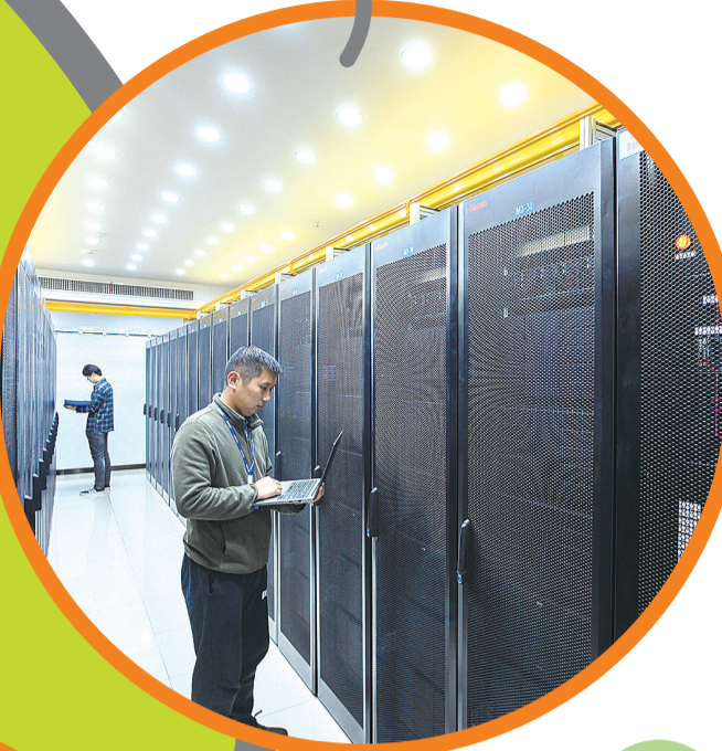
中国华录湖南数据湖产业园的蓝光存储机房,工作人员正在忙碌
