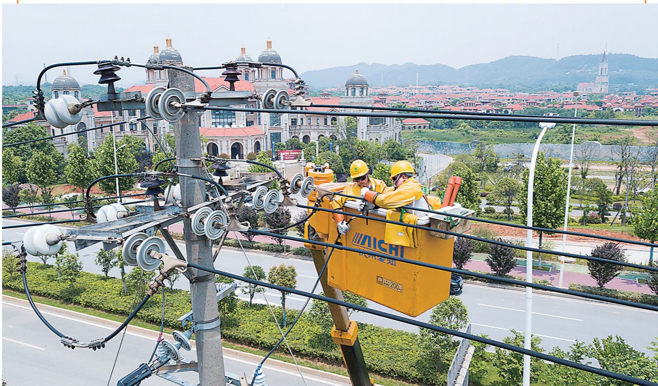
工作人员正在进行供电设施的巡查和检修,确保供电无虞。
