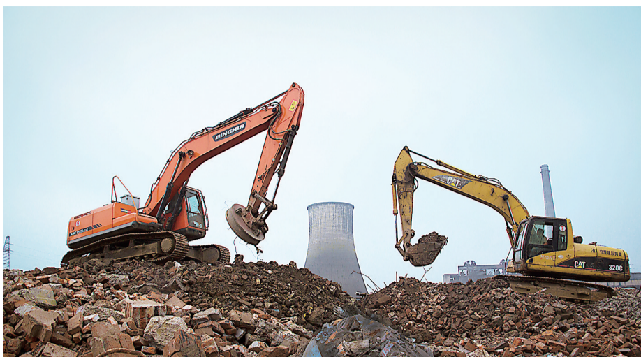
湘氨部分厂房已变成废墟,挖机后面的建筑是凉水塔
