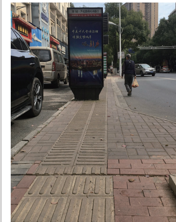
▲位于站台处的盲道条形引导砖错铺成了横向全媒体记者 刘平 摄
