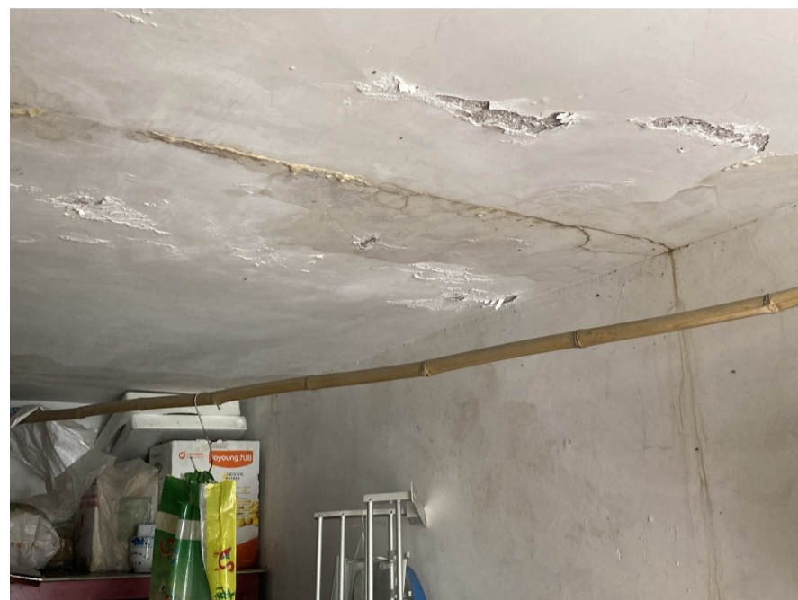
▲杂物间的天花板墙皮脱落 记者 黄欣雨 摄
