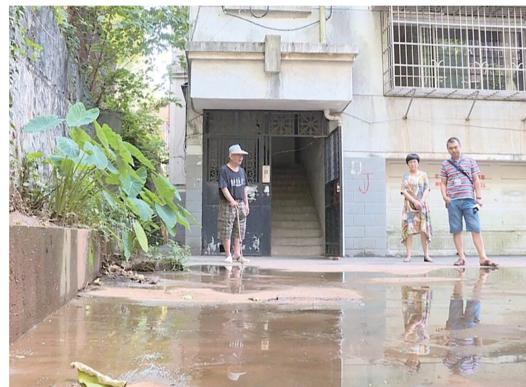
▲护坡渗出污水又脏又臭 记者 陈驰 摄
