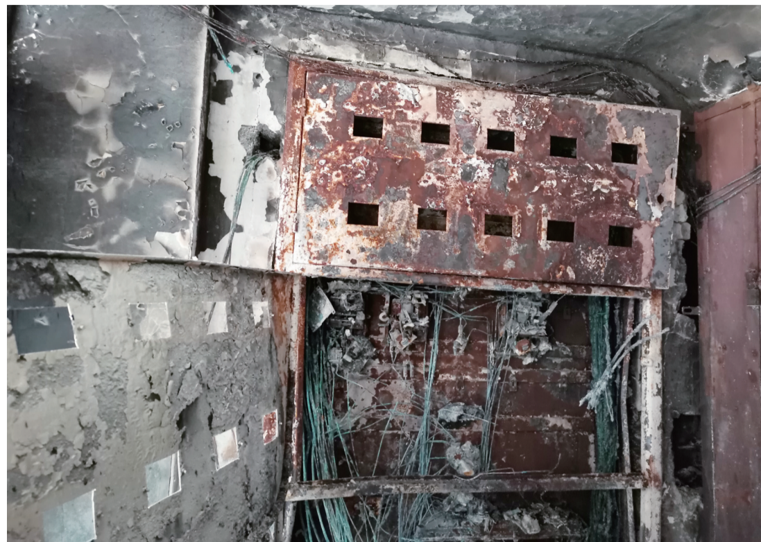
▲电表箱被烧成空壳 记者 姚时美 摄
