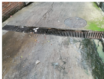
▲垃圾中转站渗滤液未经处理排入下水管道 记者 杨凌凌 摄
