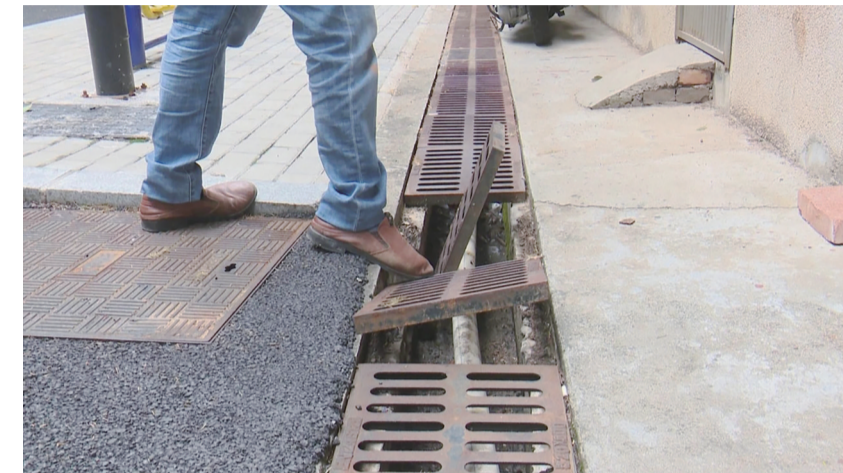
▲小区内沟盖板一脚踩翻,经常“误伤”居民 记者 陈驰 摄
