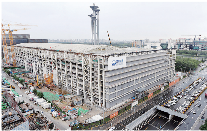
这是8月31日在北京拍摄的国家会议中心二期建设工地现场。当日,随着最后一根6米长的钢梁吊装到位,国家会议中心二期主体结构
