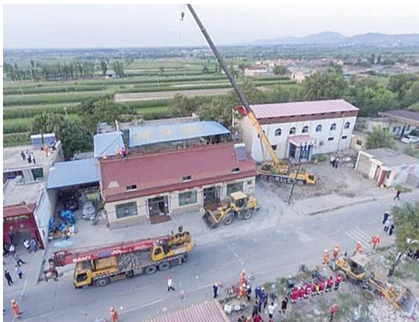
▲8月29日拍摄的事故救援现场(无人机照片)
