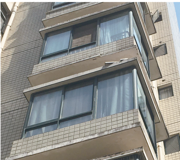
2块水泥块掉落在4栋2单元4楼窗台上方,随时有坠落危险。刘平摄
