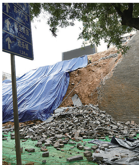
8月11日,西安市古代建筑工程公司的工人在明秦王府城墙遗址坍塌区域清理坍塌土体和砌块。新华社发
