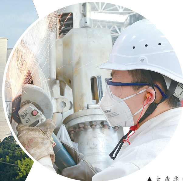
大唐华银攸县能源公司生产车间
